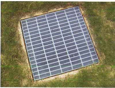
雨水枡やマンホール
