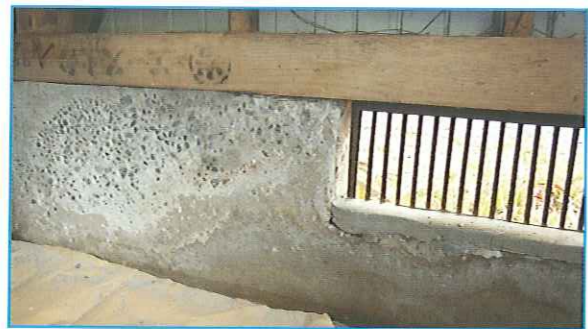
▲劣化してろくなり、ひび割れしたコンクリート基礎
