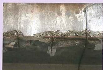
コンクリートが中性化して、鉄筋が錆つき錆と崩落の悪循環を繰り返して脆化が進行したコンクリート。
