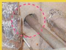
設備配管貫通穴。塞ぎ忘れによる。
