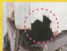
外壁波トタンの腐食による破れ
